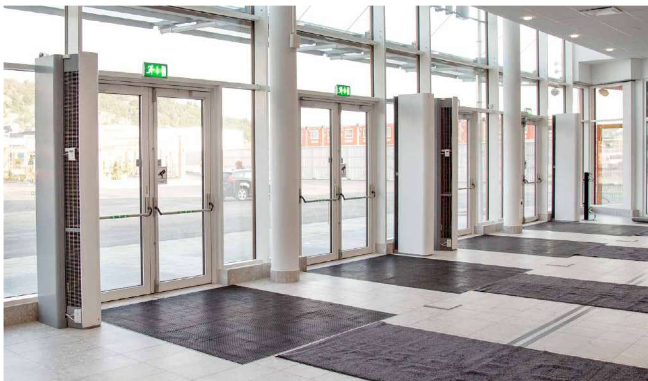
Pamir 3500 instalada en vertical con un juego de embellecedores que oculta tubos y cables.
